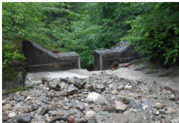
Geschiebesperre am Parschallenbach
