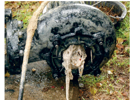
Ausgebaute, mit Feuchttüchern verstopfte Kanalpumpe (Foto: Bauhof MGO)
