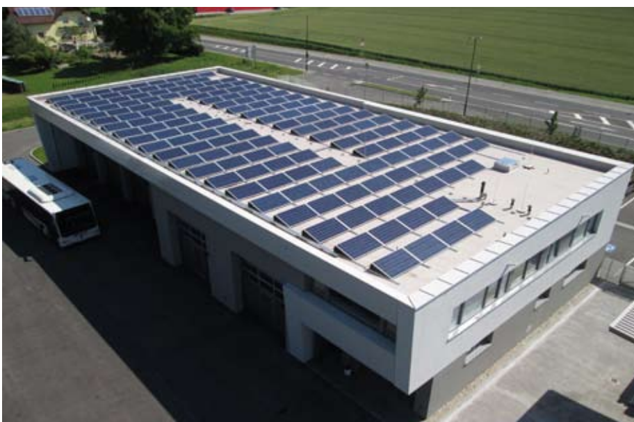
Die Errichtung der Photovoltaik-Großanlage am Dach der WILIA ist abgeschlossen. Der Projektverantwortliche der Power Solutions, DI Christoph Panhuber, berichtet uns, dass die Anlage bestens arbeitet.
