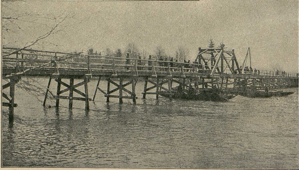
Oberes Bild: Die Arbeitsbrücke muß infolge Steigens des Wassers gehoben werden. — Mittleres Bild: Die Pionieroffiziere beim Rammbock. — Unteres Bild: Die fertige Brücke.
