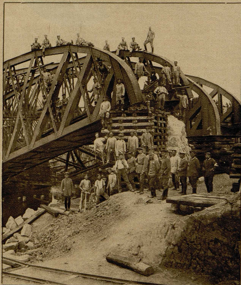
Eine von den Russen gesprengte Brücke bei Lemberg wird von einer Berliner Eisenbahnkompagnie wiederhergestellt. (Phot. A. Grohs.)
